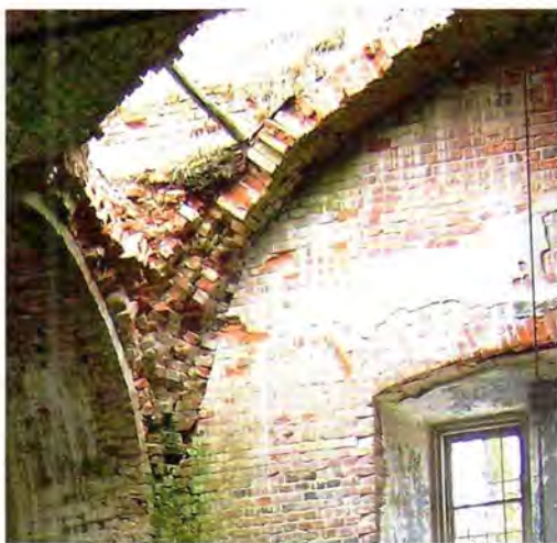
Наличие воды в пазухах сводов ведет к их обрушению. Вид изнутри храма
